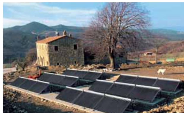
Esempio di installazione di collettori solari (foto Kloben s.a.s.)
